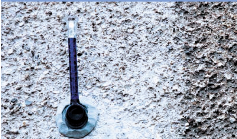
Hydrofugation en 1954 : plus de 50 ans après, l'eau ne pénètre toujours pas le substrat.
