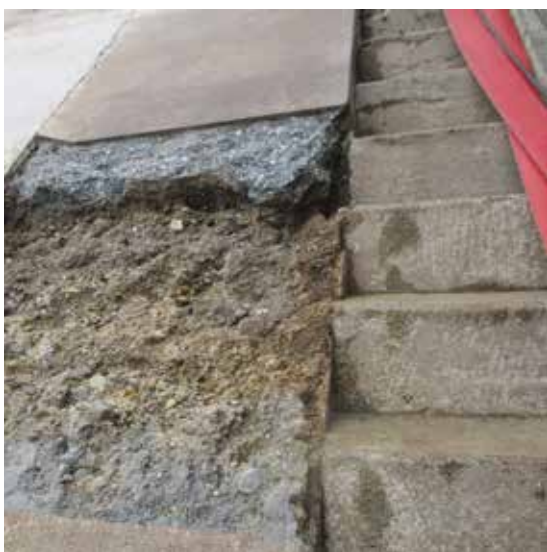
之前：混凝土大面积剥落，阿尔茨运河急需修缮。
