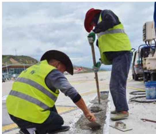
之后：使用改性混凝土修复后的路面在短短数小时内便能重新投入使用。
