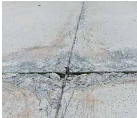
之前：伸缩缝附近的混凝土被恶劣环境和机械应力破坏。
